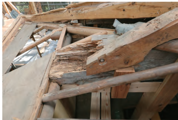
腐朽が進んでいる茶室棟玄関の梁 既存の木材に新しい木材を継いで補修します。
