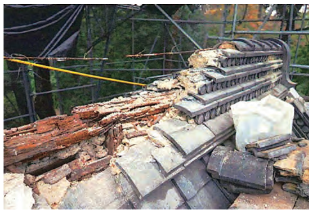
茶室棟玄関の野棟（のむね） 梃斗積（のしづみ）から雨水が入りこんだことが腐朽の原因と考えられます。 傷みがひどいため、新しい木材に取り替えます。
